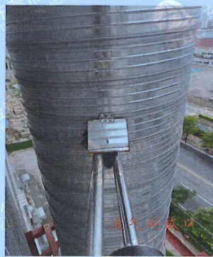
喷漆、晾干工序废气排放口
