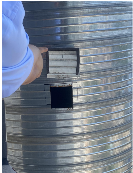
图 7 处理后采样口
