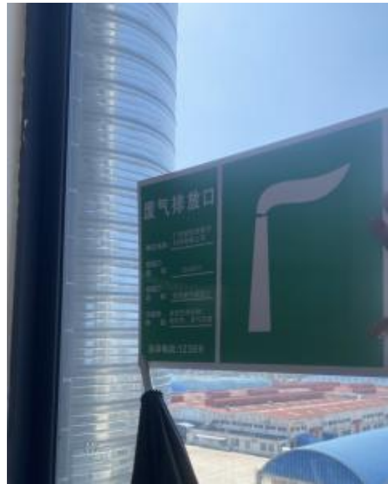
图 6 排放口标识牌
