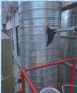
喷漆、晾干工序废气处理前
