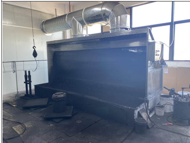
图 3 喷漆房内水帘柜
